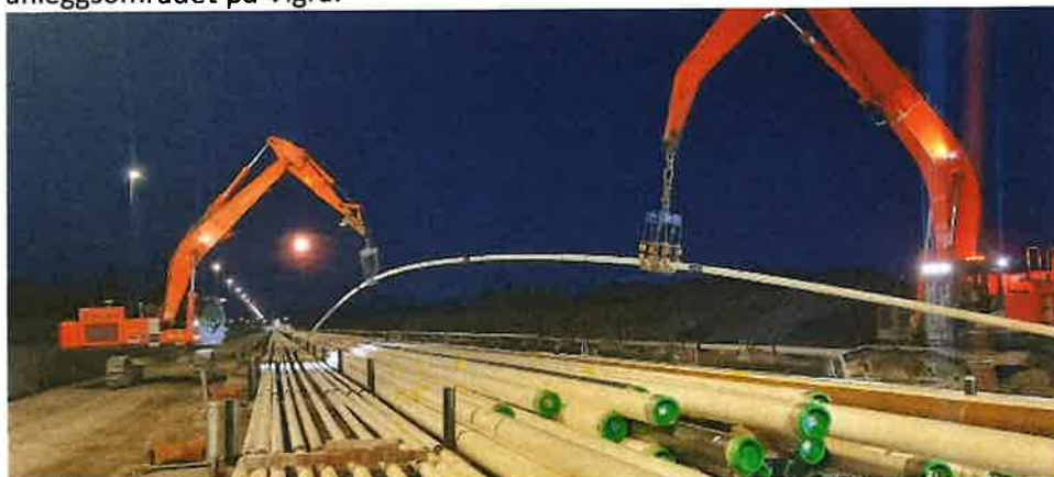
Lars håndterer store olje og gassrør på jobb for Busengdal entreprenør ved Vigra v/ Ålesund
